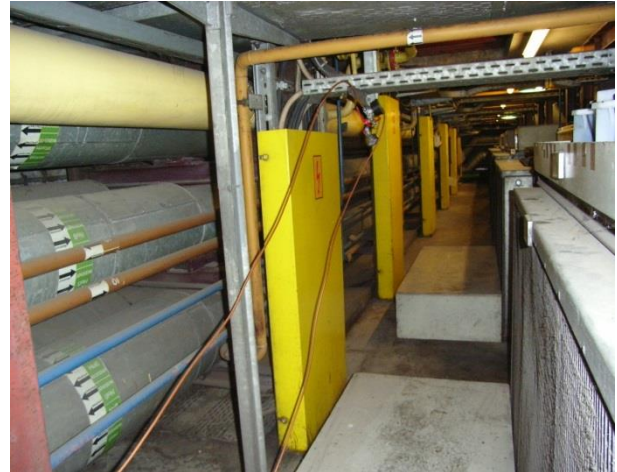
Periphere Verrohrung im Technikeller unter der Kabine
