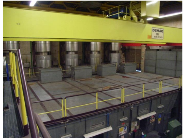
BHKW-Schalldämmkabine in der Heizzentrale
