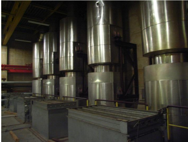
Abgasanlage und Kabinenentlüftung
