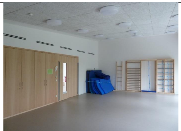
Mehrzweckraum mit Luftauslässen
