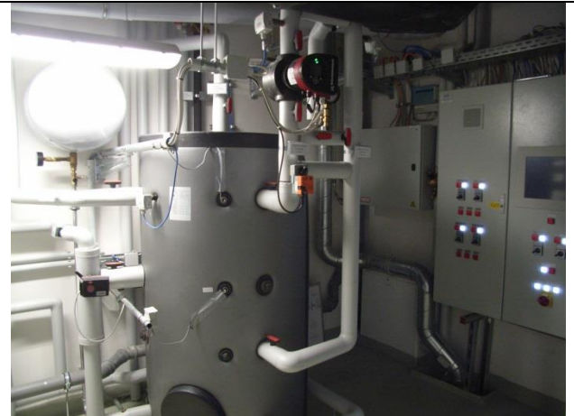
Heizzentrale mit Pufferspeicher und Schaltschrank
