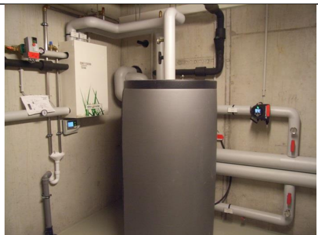
Heizungs-Pufferspeicher mit Durchfluss-Trinkwassererwärmung
