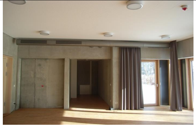
Mehrzweckraum mit Luftauslässen
