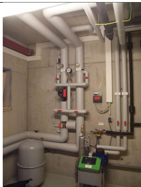
Heizzentrale mit Heizwärmeverteilung
