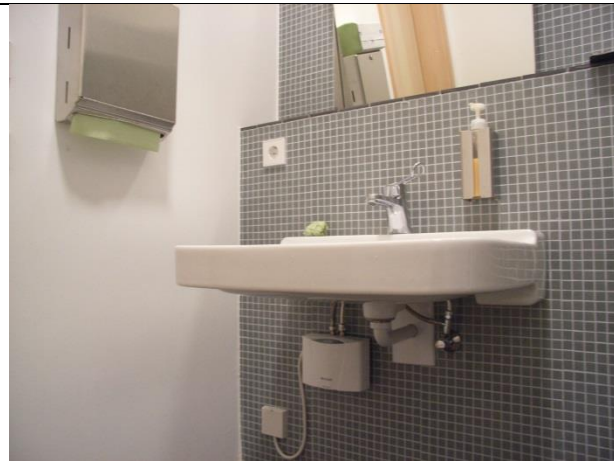
Waschtisch, unterfahrbar mit Elektro-Durchlauferhitzer
