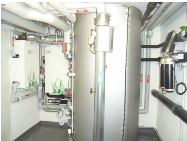
Unterkentrale RGB Neubau m. Puffer u. Frischwasserstationen
