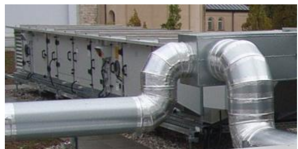
Dach-Lüftungszentralgerät RGB Neubau mit Luftverteilung
