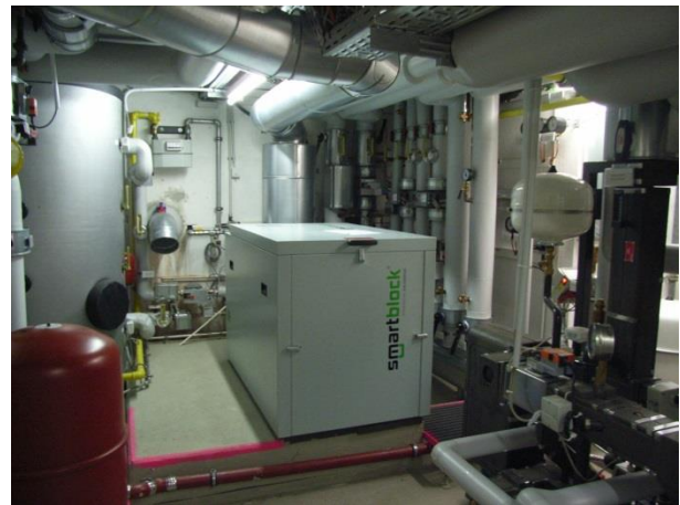
Nahwärmezentrale mit BHKW
