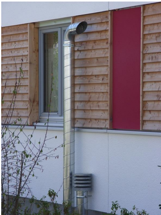
Außenluft- und Fortluftkanäle an einem Reihenhaus
