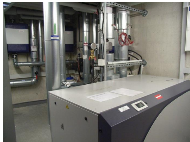
Wärmepumpe und Frischwasserstationen
