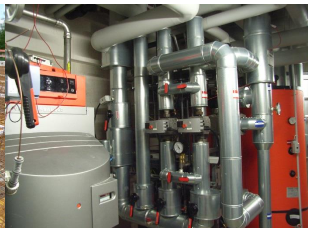
Gas-Brennwertkessel und Speicherladesysteme
