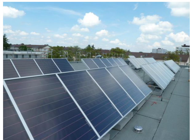
Flachkollektoren auf dem Flachdach
